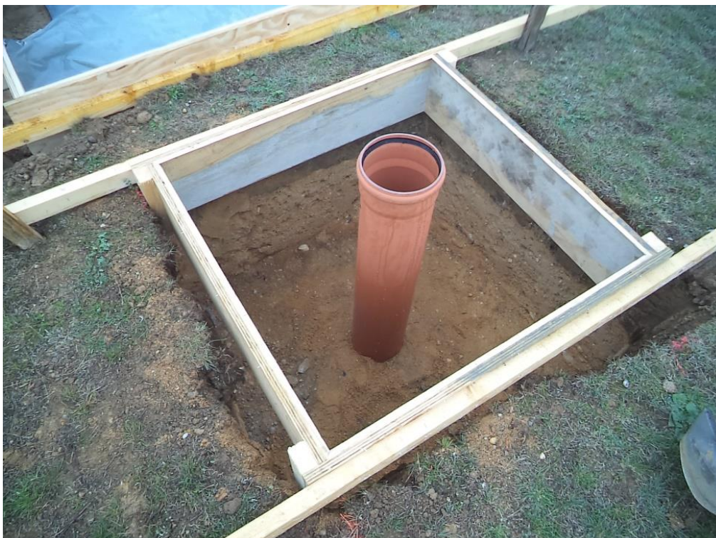
Abbildung 16: Aufnahmerohr für den Messmast
