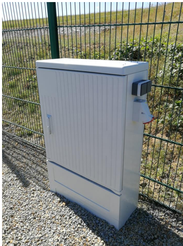
Abbildung 10: Stromverteilerkasten am Fackelstandort
