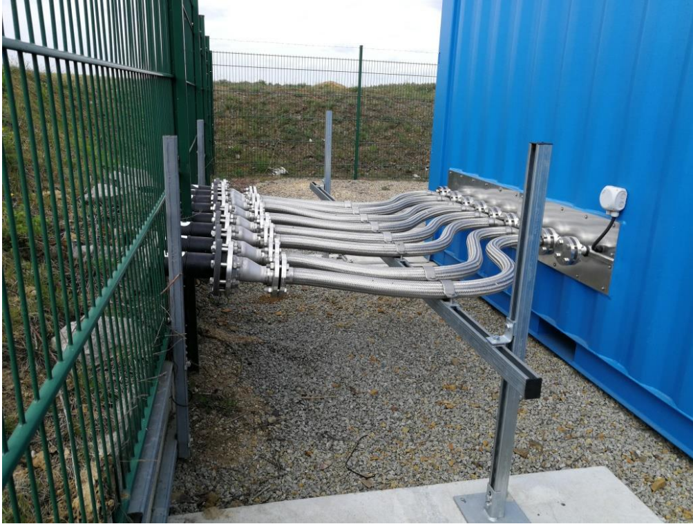
Abbildung 7: Anschluss mittels Edelstahlwellschläuchen
