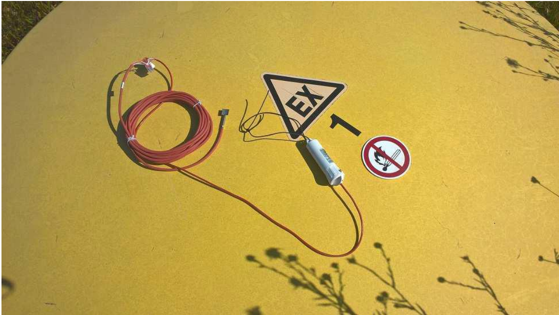
Abbildung 11: Temperatugeber vor dem Einbau im Gasbrunnen
